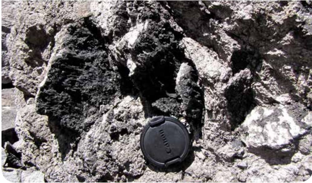
Asfaltoa erraz ikus daiteke arrokararen hausturetan.
